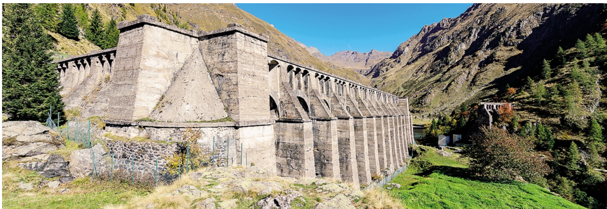
La diga del Gleno, con lo squarcio che è ancora lì a ricordare la tragedia di cento anni fa FOTO CAI VAL DI SCALVE
